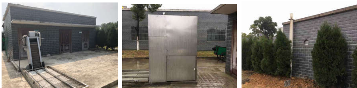
附图 5-5 格栅机、曝气池导气管图片
